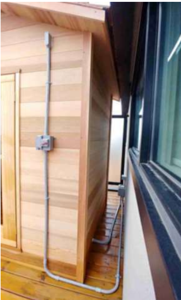
Weatherproof Conduit & Light Switch
